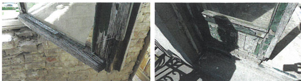
C21 – C22 : parties inférieures d'ouvrants dégradés
