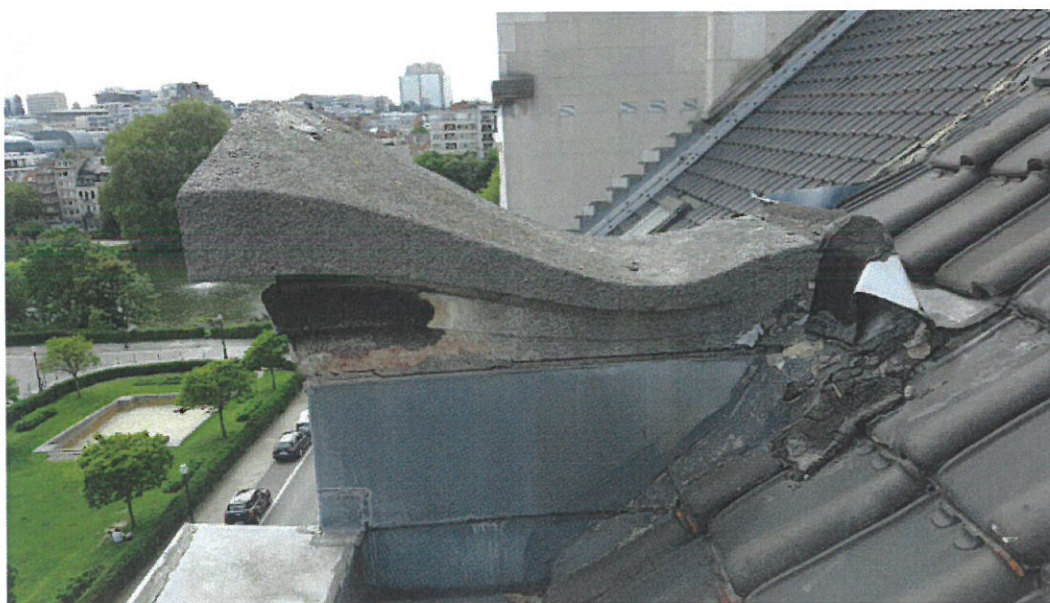
Etat des pierres bleues de couronnement latérales
