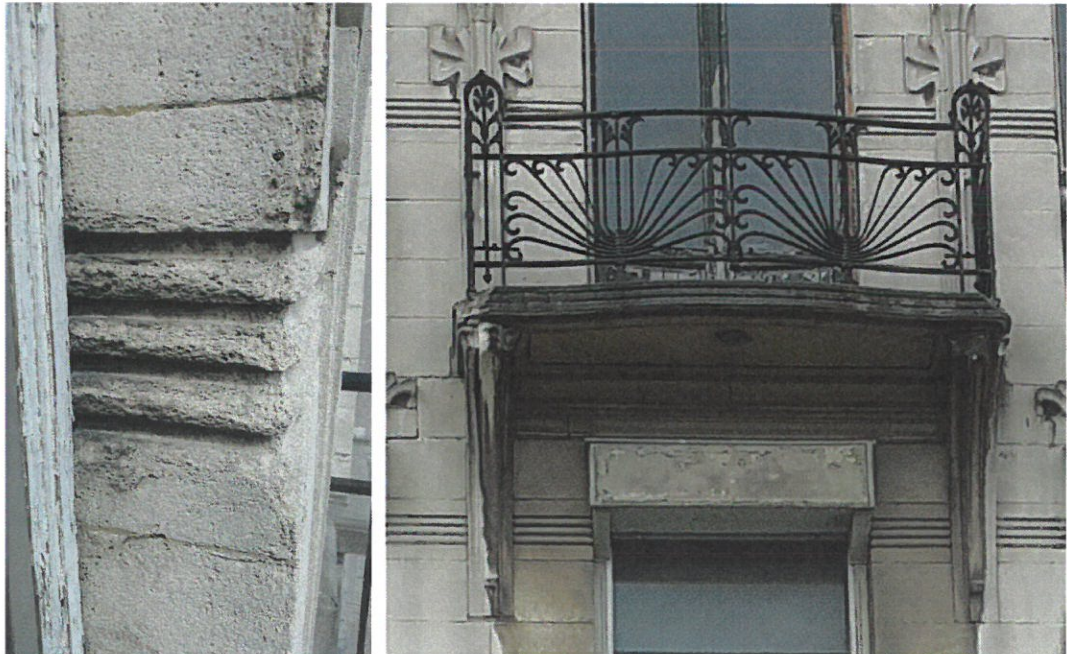
Erosions des éléments saillants en pierre d'Euville – Angles fendus et cassés du balcon en pierre d'Euville
