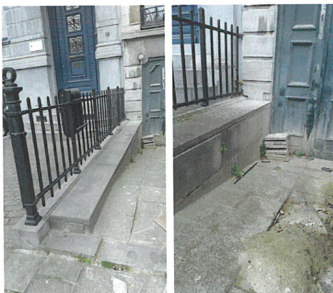
Etat du muret latéral non d'origine – descellement des pierres de parement
