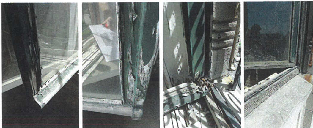
C31 – C32 – C33 – C21 : parties inférieures d'ouvrants dégradés
