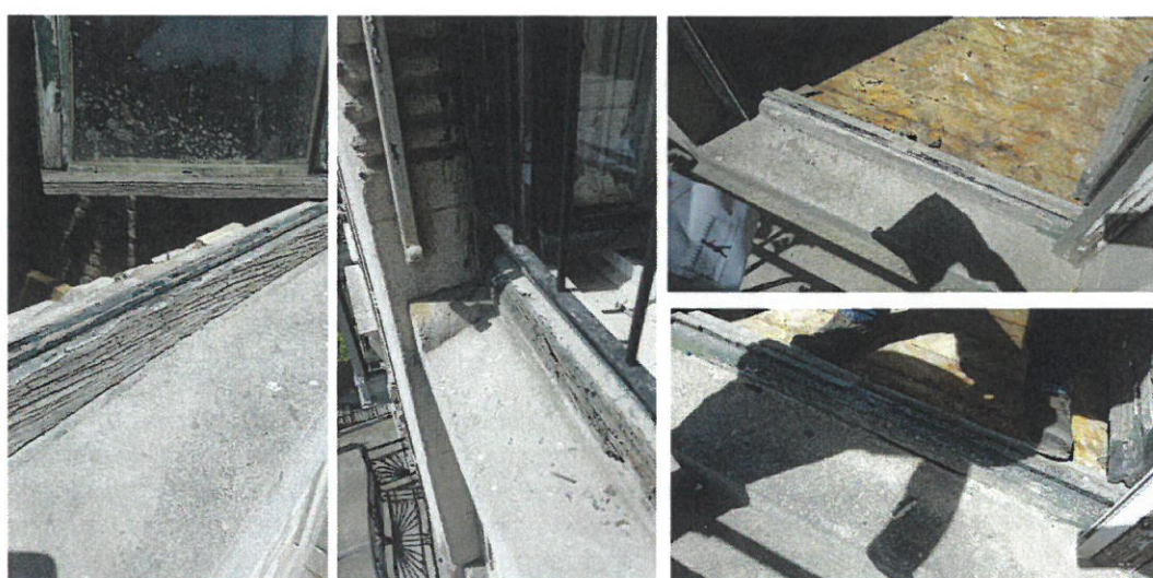
C21 – C31 – C12 – C13 : traverses d'appuis inférieures – dégradations croissantes vers les étages supérieurs
