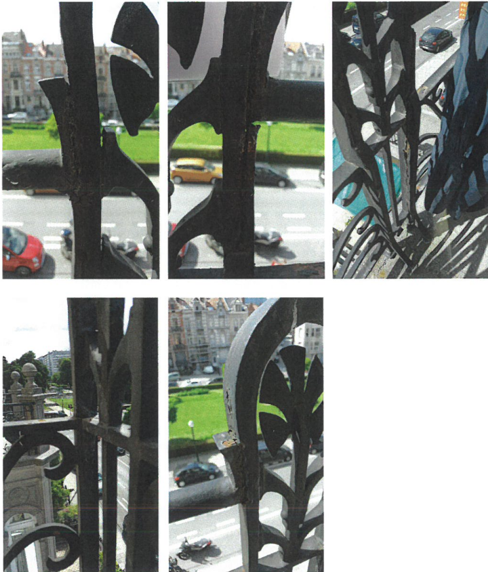
Corrosion importante à la jonction de différents éléments
