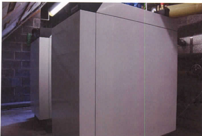
Figure 60 : Deux chaudières de 319 kW (ARIES, 2019)
