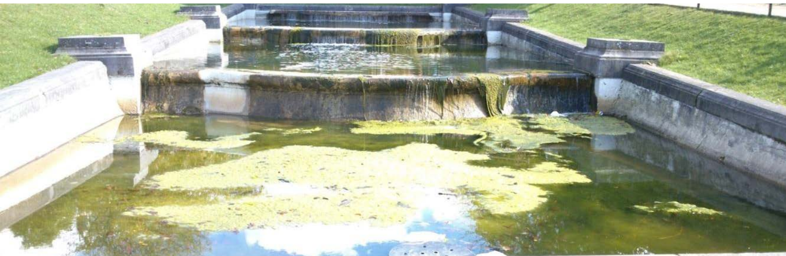
Matelas d'algues dans l'escalier d'eau
