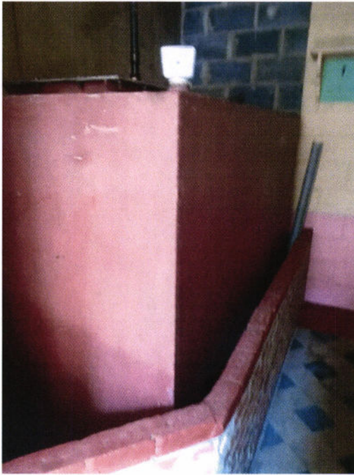
Photo n°53/ Rez-1 (sous-sol) - Chaufferie/ Tank mazout
