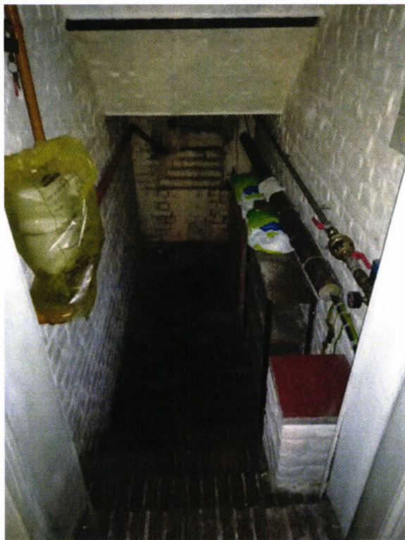
Photo n°52/ Rez-1 (sous-sol) - Hall compteurs
