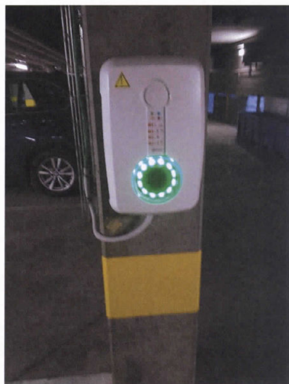
Installation de rechargement de véhicules électriques
