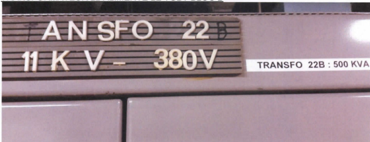
TRANSFORMATEUR 22 ALIMENTE LE TGBT BLOC B
