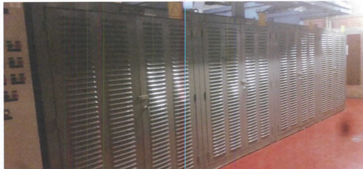
Bloc A-B: 3ème Local : 20BXL13003 ELE1 BRU/L130/03/ELE1 TRANSFORMATEUR 21 ALIMENTE LE TGBT BLOC A
