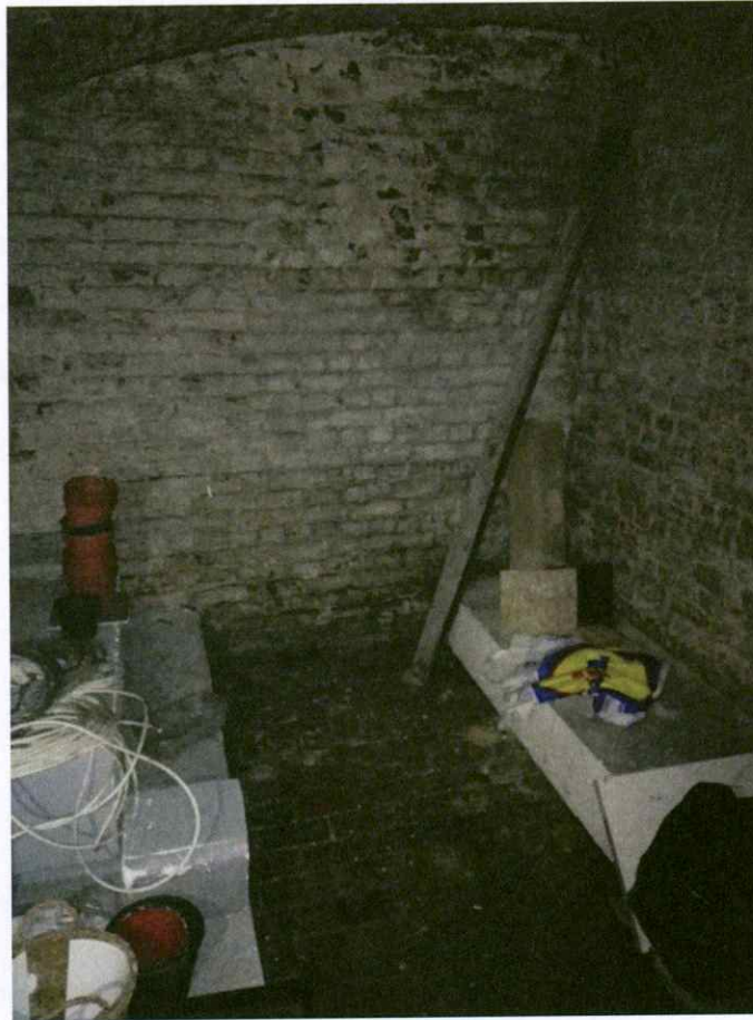
Photo 3 : Vue d'ensemble de la zone du piézomètre P2 (cave ancienne du bâtiment sis rue de la Loi 91) (niveau -1,5), direction Nord
